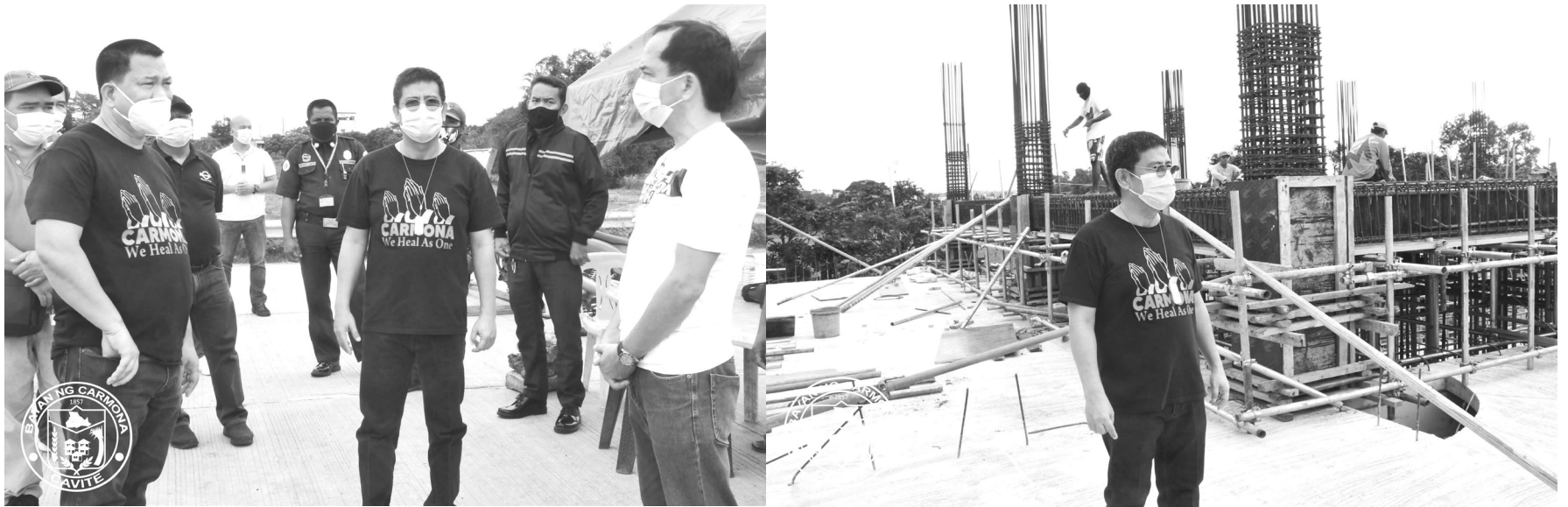
Binisita ni Carmona Mayor Roy Loyola ang ginagawang Emergency Operations Center at Multi-purpose Building sa Barangay Maduya nitong Biyernes, Pebrero 5, 2021. Kasunod nito ay binisita rin ng alkalde ang Carmona Municipal Park at ang Davilan area sa Barangay Lantic upang kausapin ang mga security personnel sa nasabing mga lugar bilang paghahanda sa muling pagbubukas ng mga ito sa publiko simula Pebrero 10.
